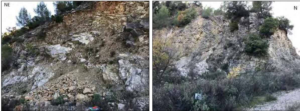
Figure 64. Zone d'éboulements liée à un pendage défavorable le long de la piste d'accès à la plateforme sommitale (à gauche) – Petits éboulements sur le flanc de la vallée sèche (à droite) (MICA Environnement)
