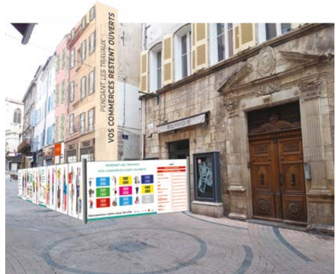
Palissade avec échafaudage + porte accès chantier Rue Cisson vers Place du Marché
