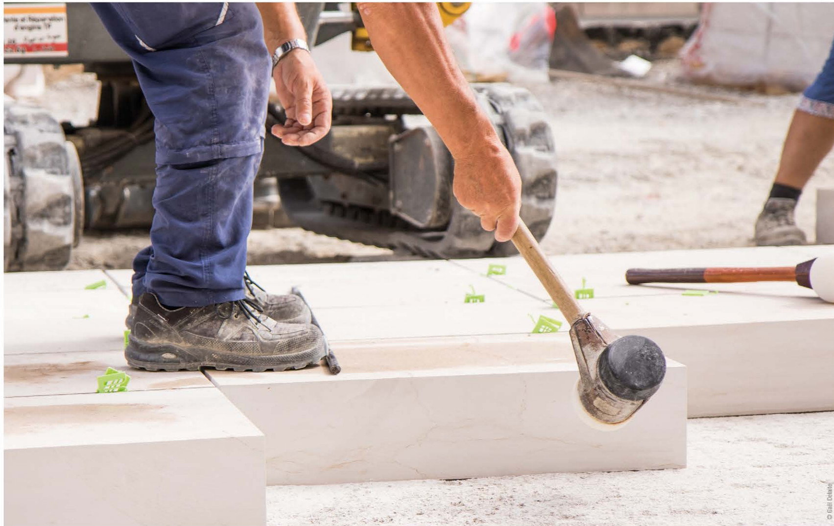
De mai à juillet 2017 - Travaux sur le cadre pluvial et mise en place des dalles des trottoirs.
